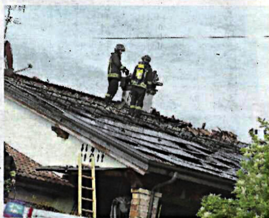
INCENDIO I vigili del fuoco sul tetto dell'abitazione dove si era sviluppato l'incendio forse a causa del fotovoltaico
